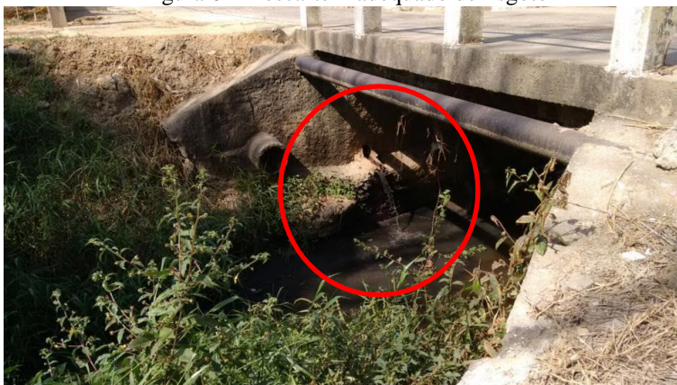
Figura 6 – Descarte Inadequado de Esgoto
