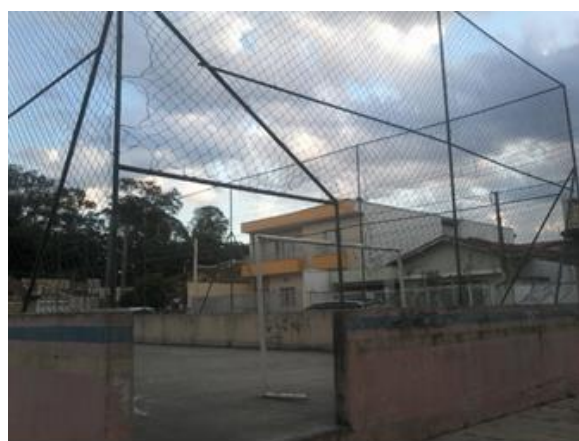
Figura 4 – Foto dos danos na quadra poliesportiva
