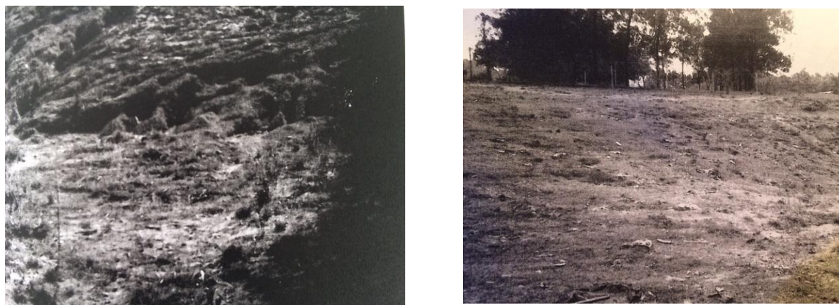
Figura 5. Foto evidenciando processo de erosão no local onde os rejeitos sólidos foram enterrados.
